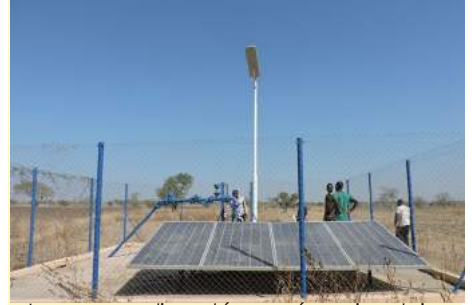
La pompe alimentée par énergie solaire
