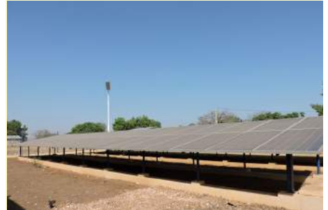
Les panneaux photovoltaïques
